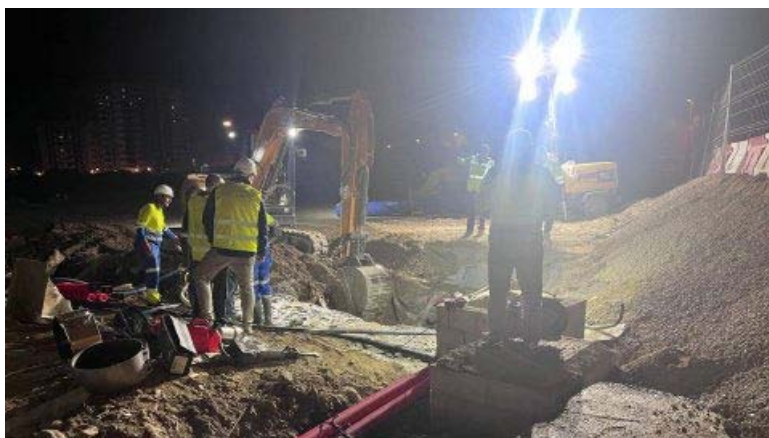
Las obras del soterramiento han provocado la rotura de una tubería de abastecimiento en Almería. Ayuntamiento de Almería
